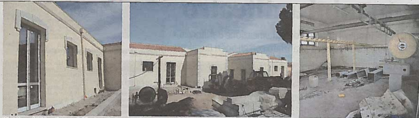
Alcune immagini del cantiere quasi ultimato per la ristrutturazione dell'ex mattatoio di via Roma. A destra, l'interno di una delle strutture prima dell'inizio dei lavori
